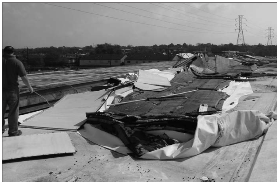
Défaillance du système de couverture d'un bâtiment commercial sous l'action de vents violents
