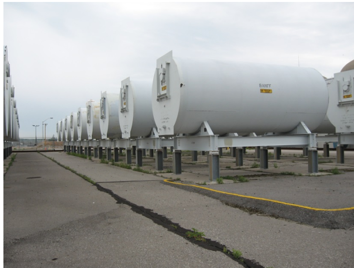
Figure H.1 : Modules de stockage à sec contenant des déchets de retubage de la centrale nucléaire de Pickering-A (tranches 1 à 4) à l'Installation de gestion des déchets de Pickering d'OPG
