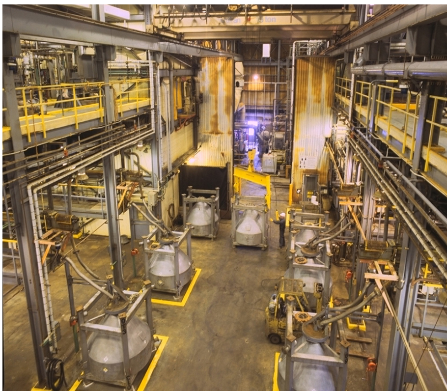
Figure 5.9 – Raffinerie de Cameco à Blind River
