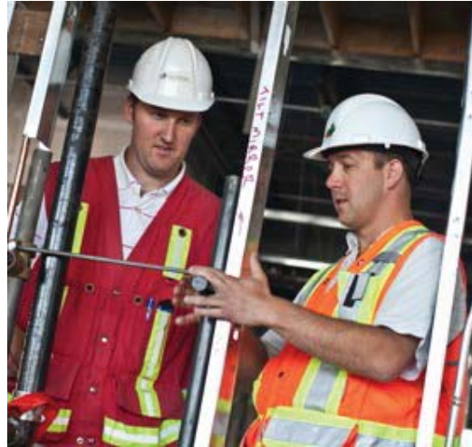
Sur la photo, à gauche est Jordan Semeschuk, le chef d'équipe des Services de construction en compagnie de Ryan Dickman, coordonnateur, Électrique, parlant des supports sur mesure durant la construction de l'installation de soins de santé à la 19 e Escadre.
