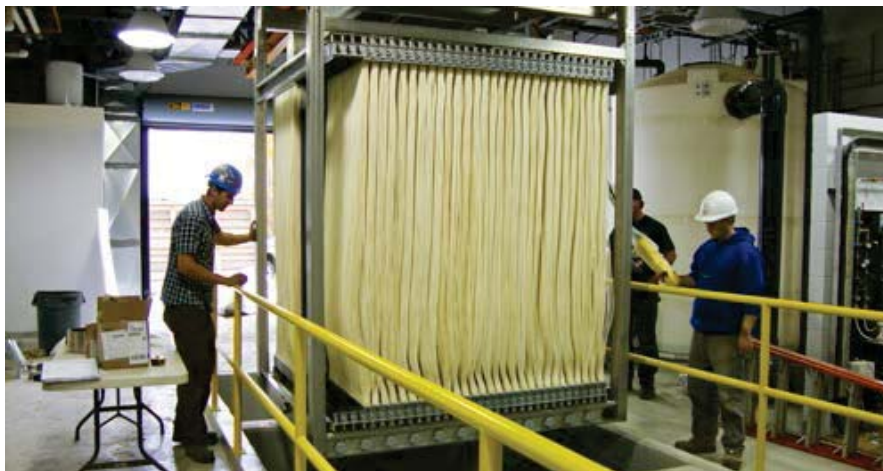
On voit la cartouche de membranes ZeeWeed 500, ce qui constitue le dernier stade de filtration de l'eau traitée avant qu'elle ne quitte la station.
