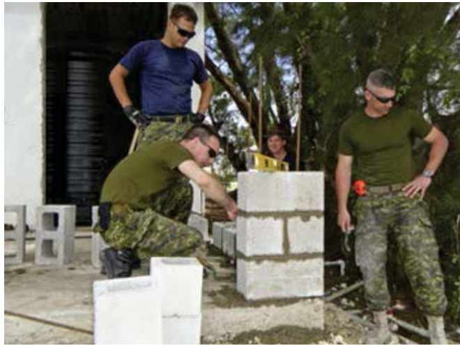
Le personnel militaire travaille à la rénovation et à la mise à niveau du réservoir d'eau en prévision de l'exercice Tradewinds à la Barbade.
