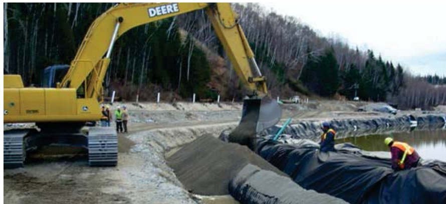
Installation d'une tranchée de récupération passive, ou système de vidange, pour arrêter et recueillir tout produit en phase libre (hydrocarbures pétroliers) qui peut fuir du parc de stockage dans les eaux souterraines et aboutir dans des eaux stagnantes.
