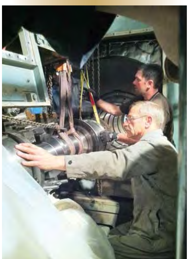
Figure 11 – Les pièces du puzzle se mettent en place. Une fois posée la nouvelle conduite d'échappement, l'auteur (devant) et le monteur Spartius Toope de l'IMFCS peuvent installer le nouvel arbre d'insertion de la turbine à gaz.
