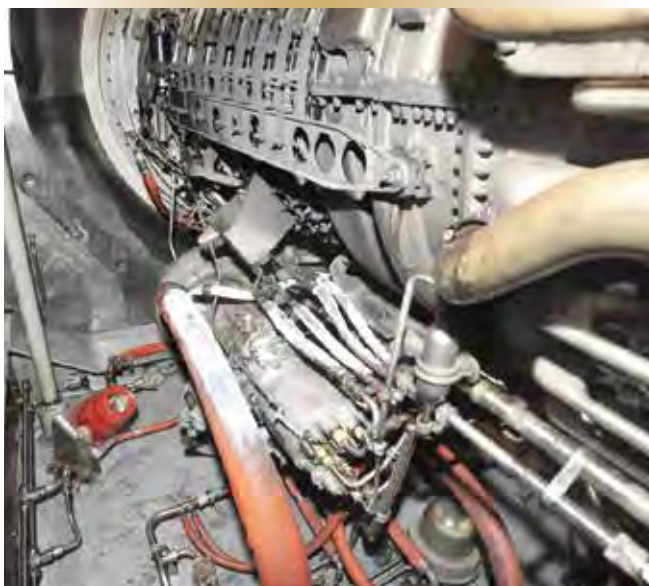
Figure 2 – De prime abord, les dégâts semblaient localisés près de la commande et la pompe à combustible vers l'extrémité avant de l'enceinte.
