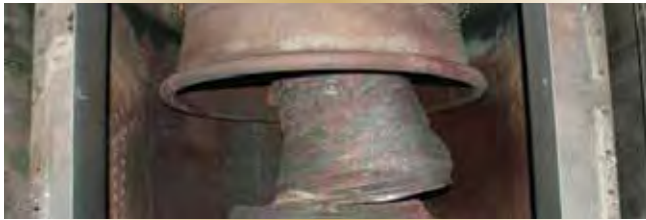
Figure 4 – En regardant dans la conduite d'échappement moteur de l'enceinte, l'équipage du navire a eu un premier aperçu des dommages causés à l'AAHV.
