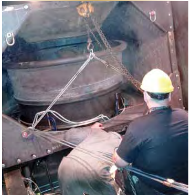
Figure 9 – Les valeurs de dégagement étaient d'aussi peu que 3 mm quand la conduite d'échappement a été déplacée avec soin à travers l'enceinte pour son retrait.
