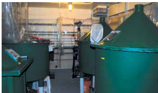
Installation de bioconfinement. Photo : Nellie Gagné (MPO)
