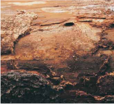
Dégâts et trou d'entrée des larves
