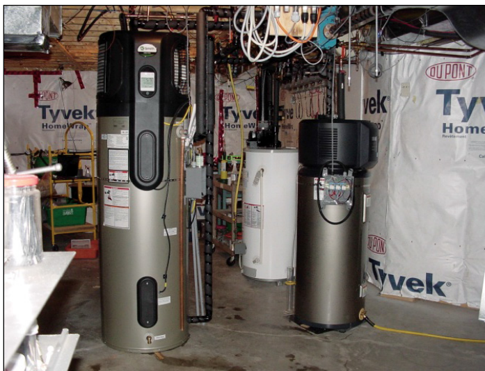
Figure 1 Chauffe-eau à pompe à chaleur installés dans le sous-sol de la maison d'essais du CCTR. (À gauche : chauffe-eau à pompe à chaleur A – 80 gallons américains / 303 L; à droite : chauffe-eau à pompe à chaleur B – 50 gallons américains / 189 L)
