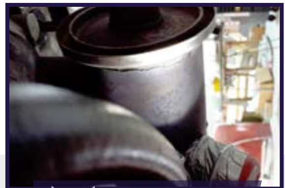
Fissure considérable dans le silencieux près de la bride
