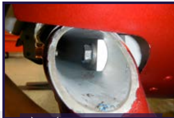
Vue du carénage du train d'atterrissage; l'écrou fissuré n'est pas visible
