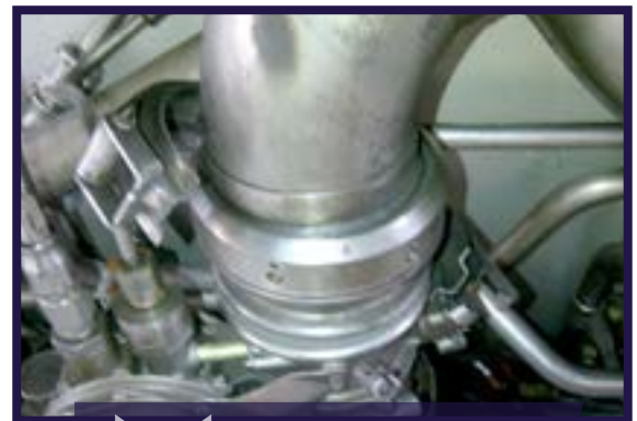
Bride de serrage défectueuse sous la pièce de retenue du boulon en T
