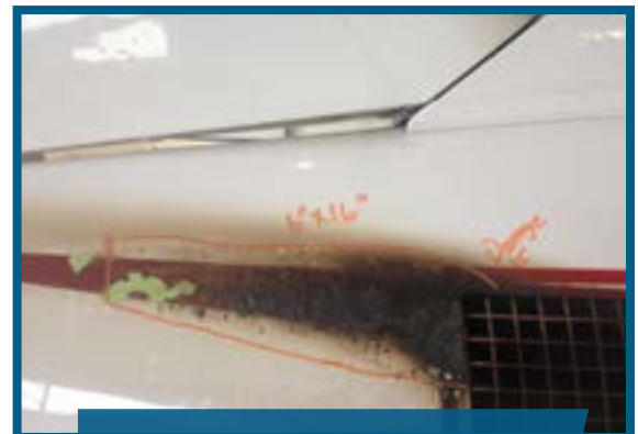
Évidence de dommages importants au cône de queue du groupe auxiliaire de puissance
