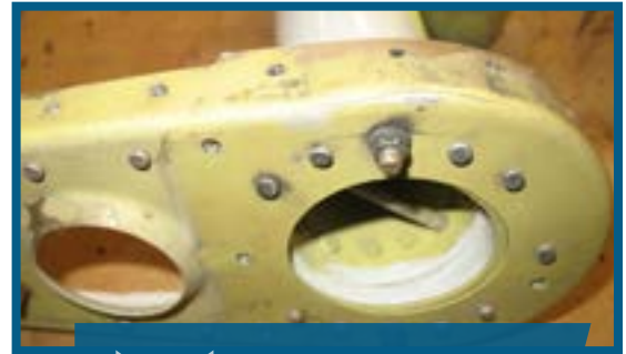
Fissures sur la nervure près du boulon de fixation
