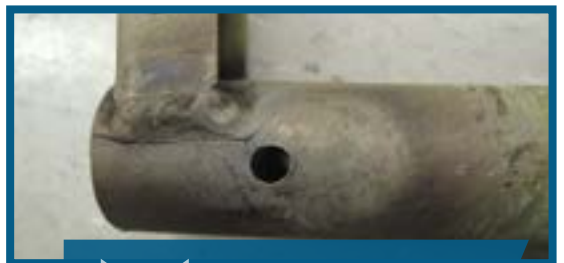
Fissure du trou de boulon
