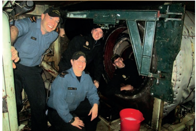
Figure 3. On a installé un bras pivotant pour manœuvrer le moteur dans l'espace clos des machines.
