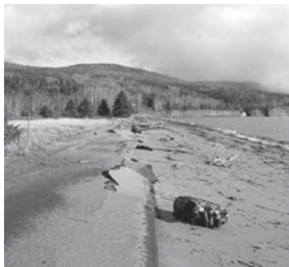
Les dommages récurrents causés à la route nuisent à l'expérience de visite. Parcs Canada
