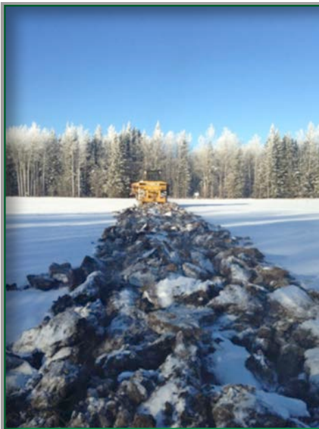
Figure 2b. Deuxième passage superposé à ceux du dessous de la sous-soleuse à ailerons fixée au bras d'un bulldozer
