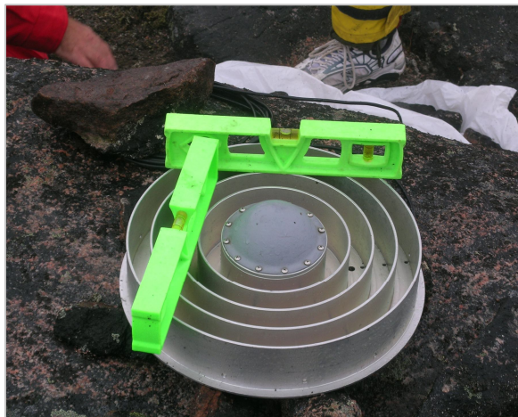
Installation de l'antenne GPS de haute précision.
