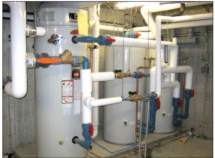
Figure 6 Chauffe-eau au gaz et réservoirs de stockage (Source : L'CEUF s.e.n.c.)
