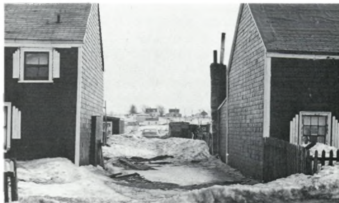
Un logement a été enlevé d'une rangée et les murs ont été isolés et revêtus de bardeaux par les charpentiers de la Citizens Service League.
