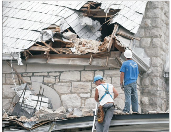
Une église a été endommagée lorsqu'une cheminée s'est effondrée à Gracefield, au Québec (Adrian Wyld, The Canadian Press)
