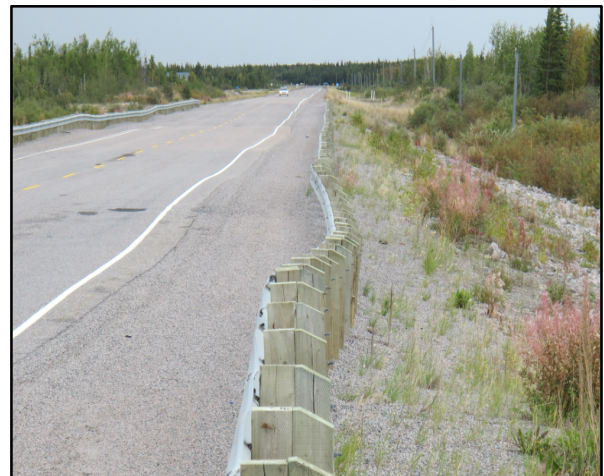
Affaissement du sol et mouvement de pente sur la nouvelle route 3 dans les Territoires du Nord-Ouest causés par le tassement du sol et le dégel du pergélisol sous le remblai. Photo prise par S. Wolfe.
