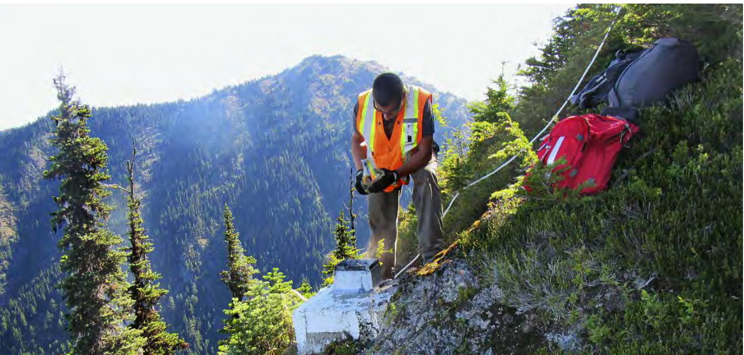
Un employé de la Commission de la frontière internationale répare une borne dans les Cascade Mountains en Colombie-Britannique.
