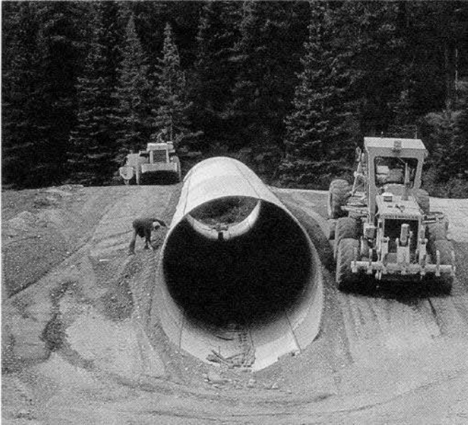
Réalisation d'un passage inférieur en vue de faciliter le passage des animaux, réduire le nombre d'animaux tués sur la route et améliorer la sécurité du public dans le Parc national de Banff.
