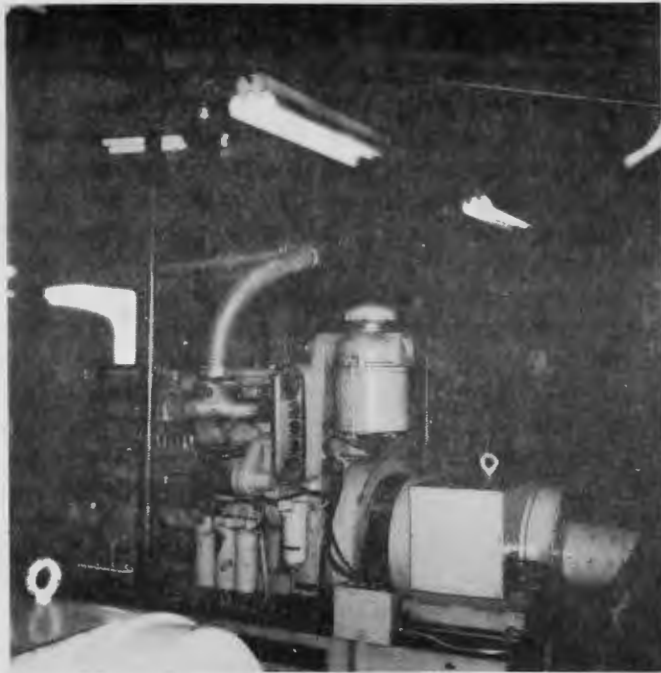
M. Jean Lafontaine contemple le groupe électrogène à moteur diesel à Inoucdjouac. Jean Lafontaine inspects the diesel electric plants at Inoucdjouac.
