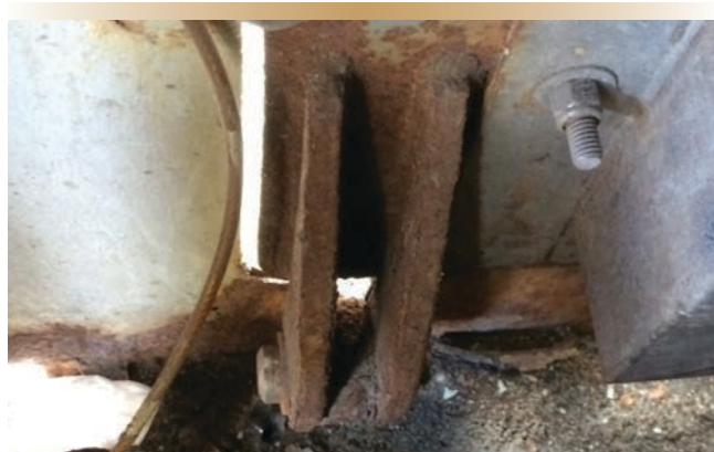
Figure 3. Une charnière et l'axe d'articulation d'un louvre de contournement qui ont saisi sous l'effet de la corrosion.
