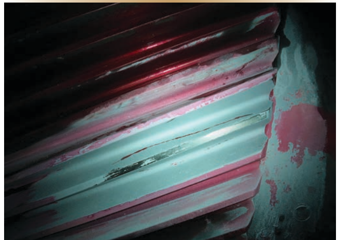
Figure 2. Fissure de surface révélée à l'aide de la détection par ressuage.
