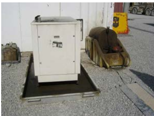
Figure 5 : Confinement secondaire pour une génératrice
