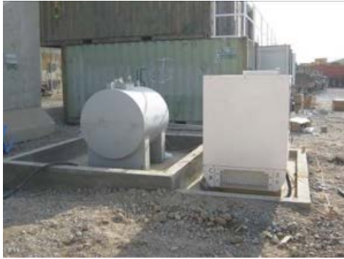
Figure 6 : Digue en béton pour confinement secondaire pour carburant et génératrice
