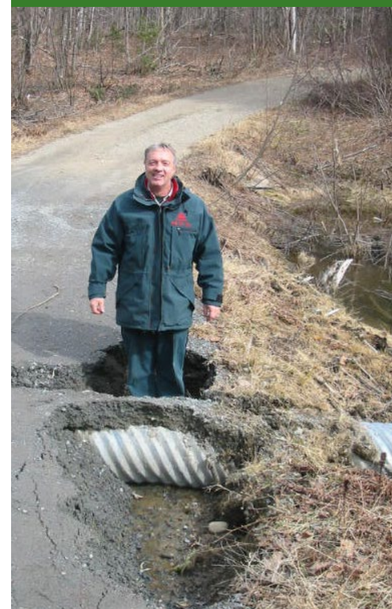
Figure 5 : Yves Marcouiller inspecte un ponceau effondré dans le parc national de la Mauricie. Quand un ponceau se bouche ou qu'il est trop petit pour gérer les débits de pointe, l'eau érode le gravier, ce qui entraîne un risque pour le public et, parfois, un dépôt de sédiments dans les frayères. (Photo : D. Masse, Parcs Canada)
