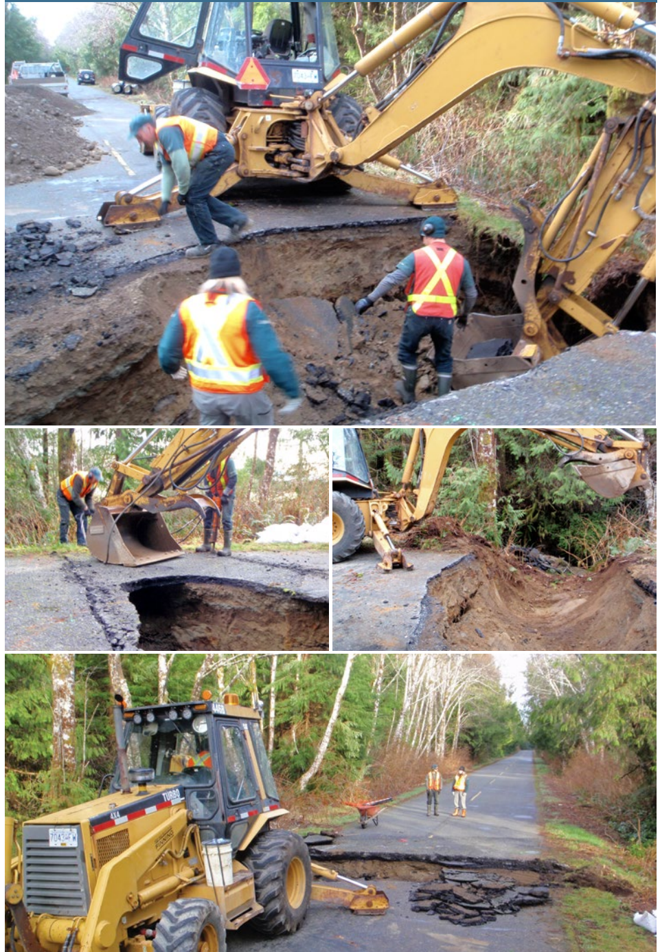
Figure 11 : Des employés de Parcs Canada remplacent un ponceau dans la réserve de parc national du Canada Pacific Rim. Les cartes de l'Infrastructure de géomatique permettront aux employés de partager leur savoir corporatif pour prévoir les risques à la sécurité des employés (p. ex. en précisant l'emplacement des câbles souterrains), maintenir les infrastructures bâties, assurer l'intégrité écologique, protéger les ressources culturelles et respecter les valeurs autochtones.
