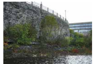
Plus de 600 structures différentes (p. ex., murs de soutènement, plateformes de belvédère, barrages)
