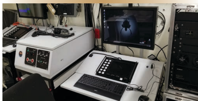
Figure 6. Le poste de commande temporaire du V-200 installé dans le bureau du technicien du GSC à bord d'une frégate.
