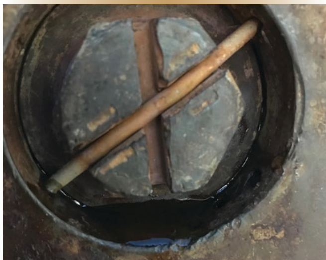
Le bouchon de vidange de la chambre « avant », qui montrait des signes de suintement d'huile, s'était replié d'un quart de tour.
