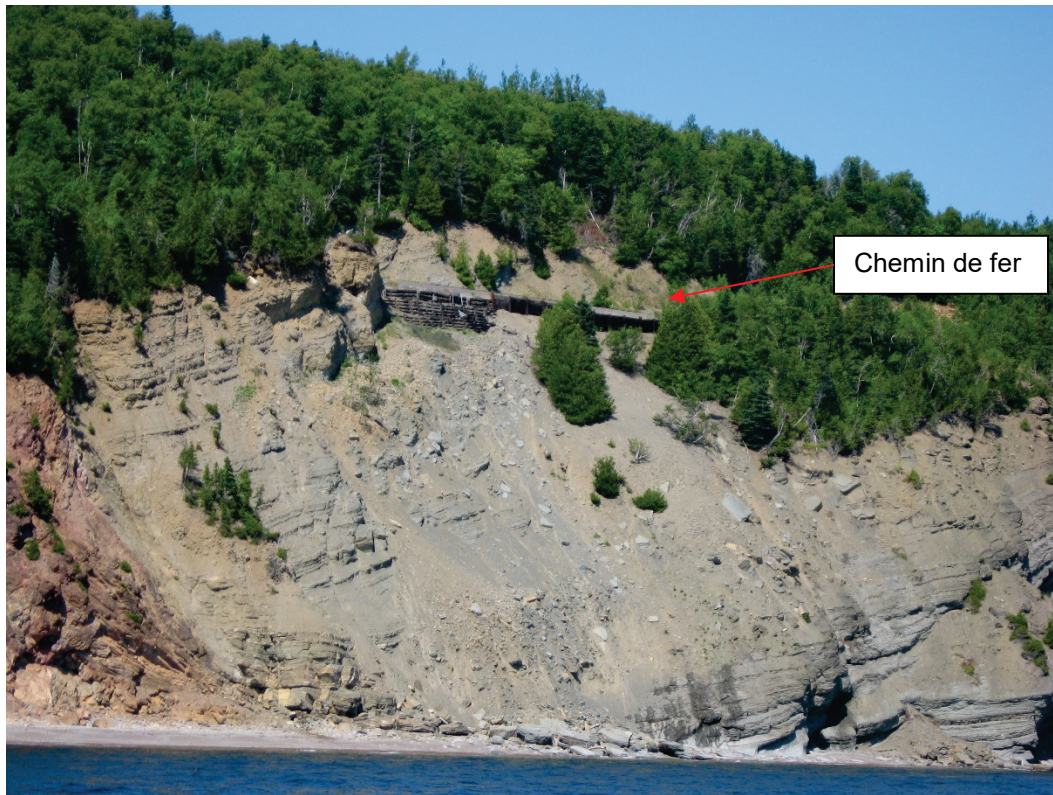
Figure 2.3 Partie aval du glissement de Gascons.
