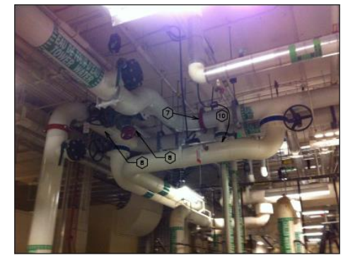
Tuyauterie des tours de refroidissement des immeubles du CNRC
