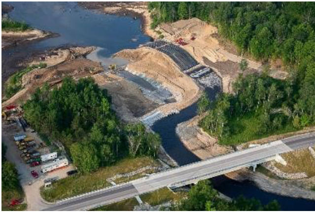
Projet de restauration de l'écosystème des barrages de la rivière Boardman. Source : USACE.
