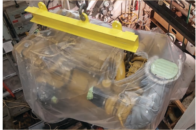
Figure 4. Un nouveau moteur Caterpillar CAT ACERT32, toujours dans son enveloppe protectrice, est monté dans la salle des machines auxiliaires arrière. Remarquer les dégagements serrés.
