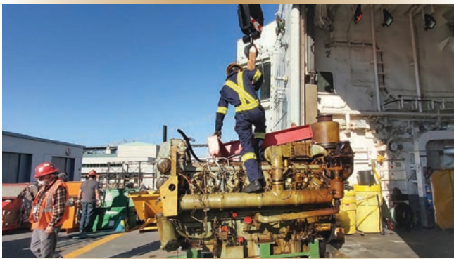
Figures 2a et 2b. Un ancien moteur MWM 602 est gréé et prêt à être soulevé hors de la salle des machines auxiliaires arrière, puis ramené à terre.
