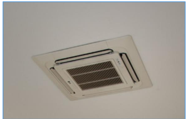
Figure 11 : Unité intérieure installée au plafond
