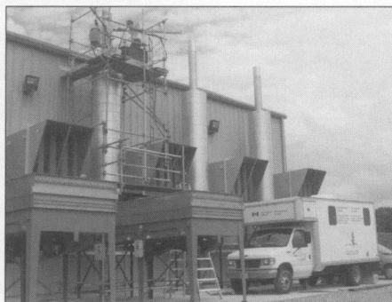
Le groupe sur l'échantillonnage des émissions de cheminées de la DRME recueille des émissions d'une génératrice électrique alimentée par des gaz d'enfouissements à Waterloo, Ontario.
