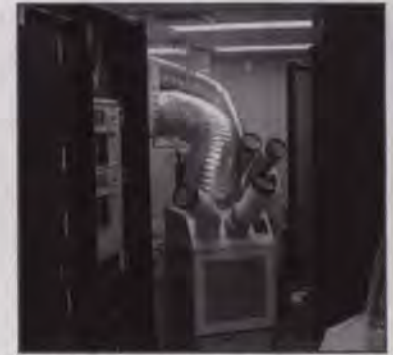
Climatiseurs portatifs en services dans une salle de serveurs
