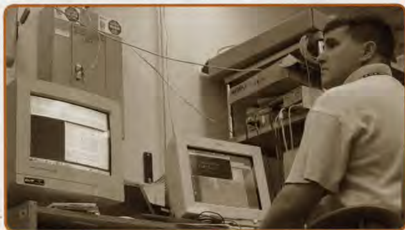
Salle des serveurs à l'édifice CD Howe.
