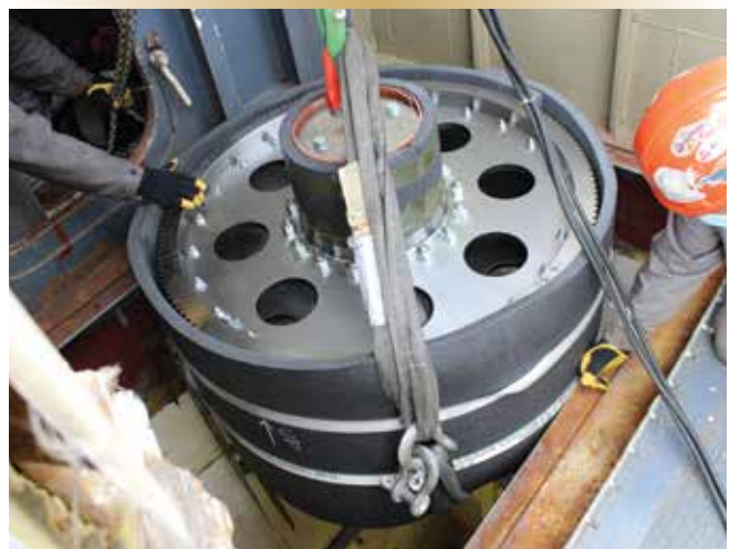
Figure 2. Le nouvel engrenage est abaissé dans le placard à joint plastique malgré un dégagement de quelques millimètres à peine.
