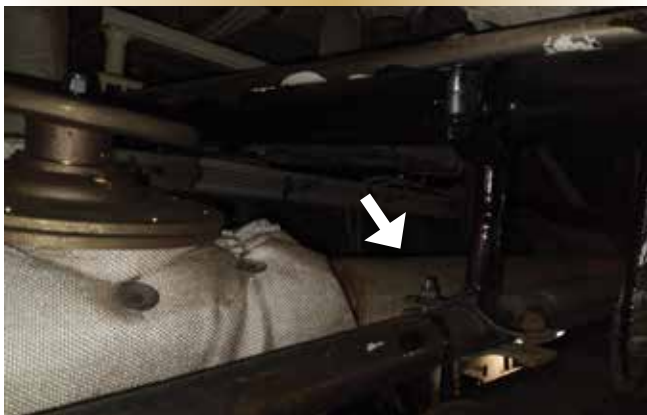
Figure 6. Alimentation de l'ACEM dans la salle des machines avant.
