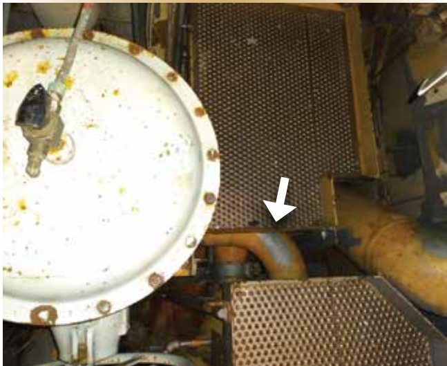
Figure 5. Alimentation du système auxiliaire de circulation d'eau de mer (ACEM) dans la salle des machines arrière.
