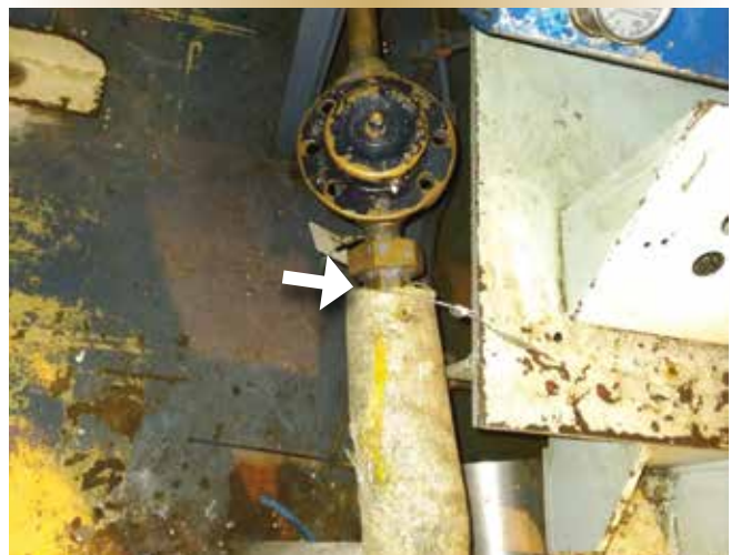
Figure 4. Circuit flexible vers la conduite principale de retour d'eau refroidie.
