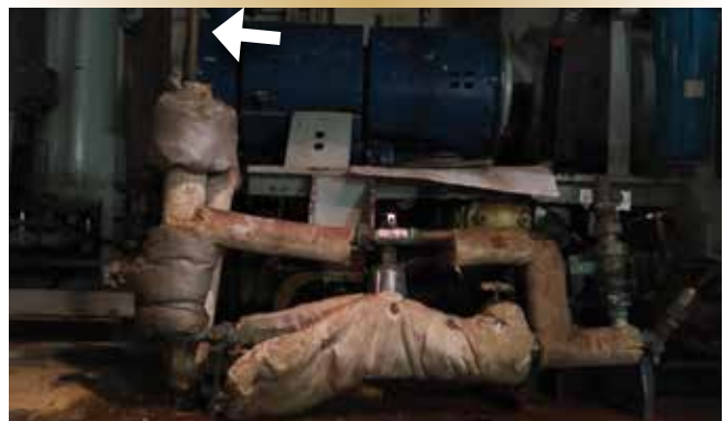
Figure 3. Circuit flexible vers le circuit de refroidissement du compresseur ABP.
