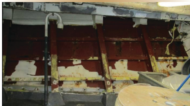
Figure 1. Zone de charpente d'acier corrodée du côté bâbord de la mezzanine du gaillard d'avant.
