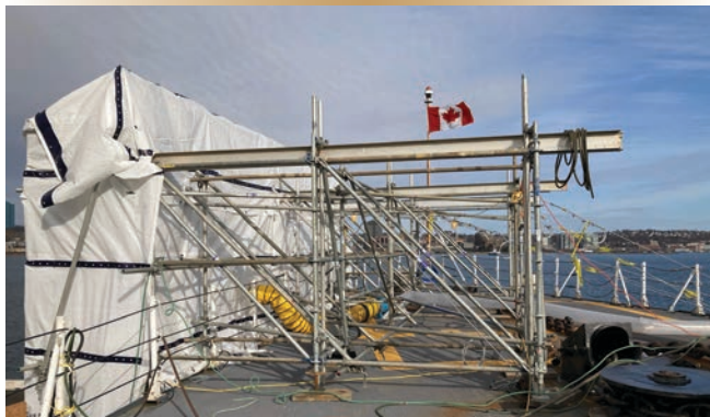
Figure 3. Structure de soutien de l'échafaudage suspendu.
