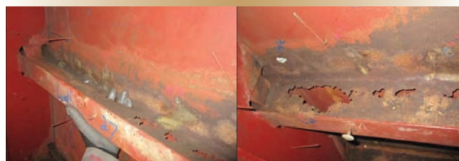
Figure 2. Sections perforées et dégradées de la lisse.
