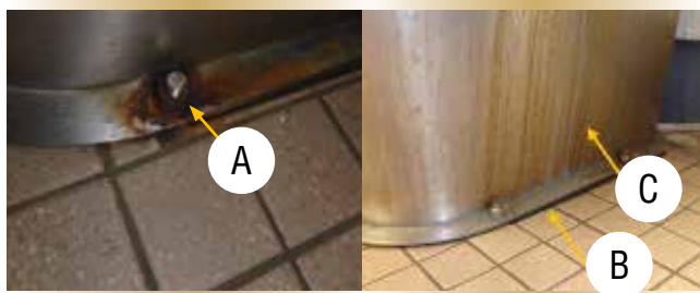
Figure 8. Corrosion de toilettes en acier inoxydable.
