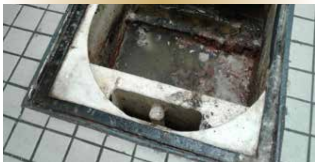
Figure 7. Défaut et corrosion du revêtement d'un collecteur de graisse de cuisine.
