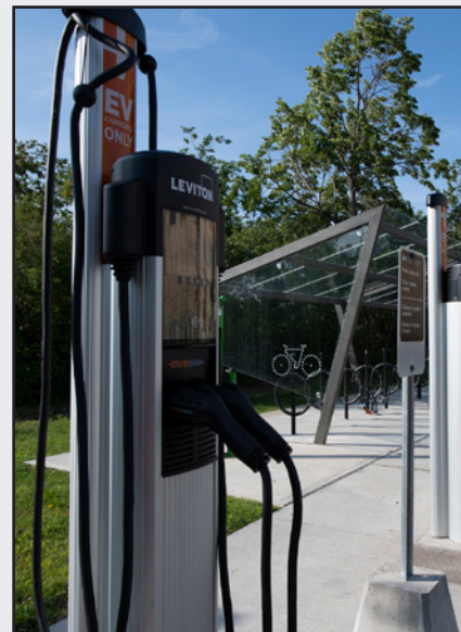
Bornes de recharge pour véhicules électriques
