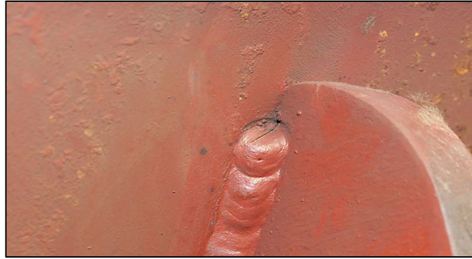
Figure 8. Gros plan d'une fissure dans la soudure unissant le prolongement de traverse pivot et la plaque de renfort de traverse pivot
