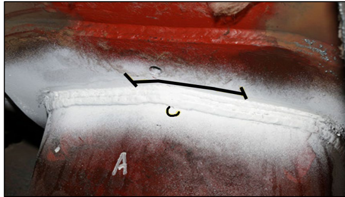
Figure 7. Emplacement de la fissuration relevée dans la soudure de la cale de bout de citerne, au bout A du wagon TGOX 155010, montrée en noir
