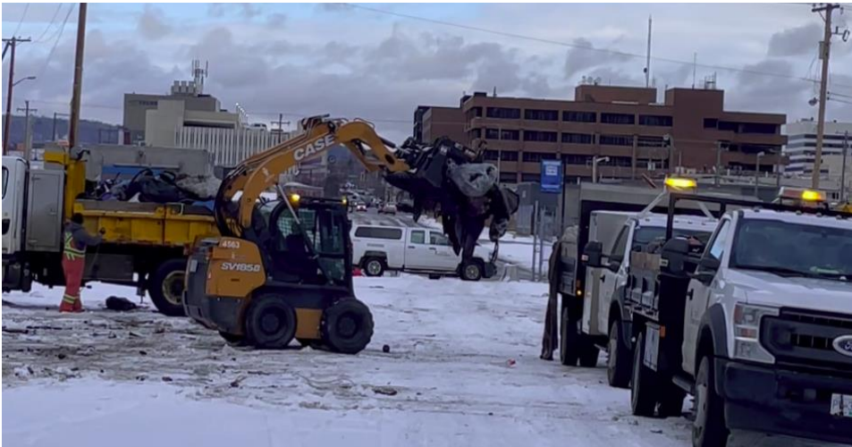
Figure 4 : Une chargeuse compacte conduite par le personnel de la Ville de Prince George charge les débris des abris démolis dans les camions de la Ville. Image fixe (à 46 secondes) de pièce justificative vidéo B, 7e déclaration sous serment de Michelle McGregor, numéro de dossier iMG_9670_MOV 7 décembre 2021. Dossier n° 2160169, registre de Prince George.
