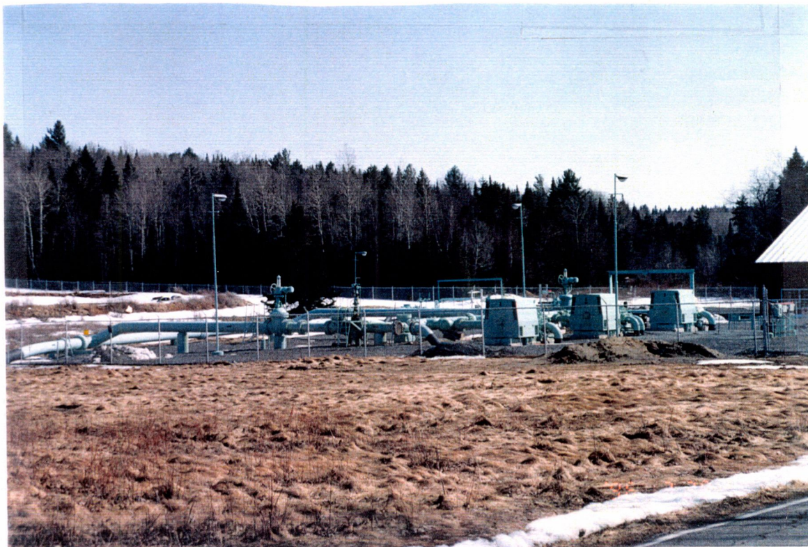
Pipelines et vannes d'isolement
