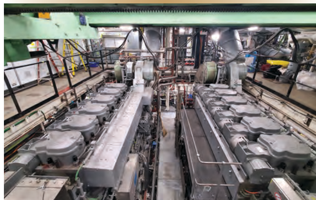
Figure 1. Deux des quatre moteurs diesel MAN de 3 600 kW du NPEA qui fournissent de l'énergie électrique pour les systèmes de propulsion et les systèmes électriques des navires.
