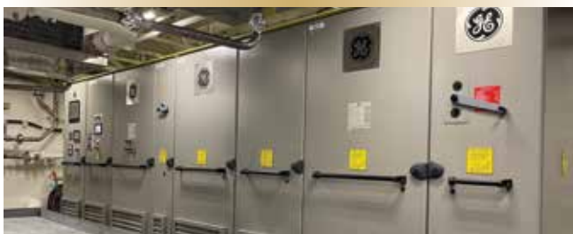
Figure 1. Armoires de convertisseurs dans la salle des moteurs supérieure tribord à bord du NCSM Margaret Brooke (AOPV-431).
