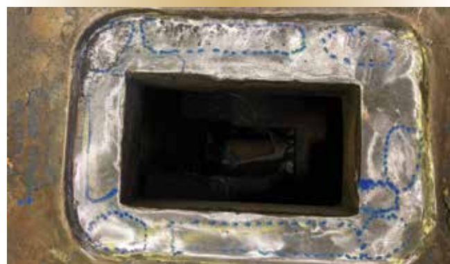
Figure 4b. Chemin de clef – défauts décelés par contrôle aux ultrasons (6 mai 2022).
