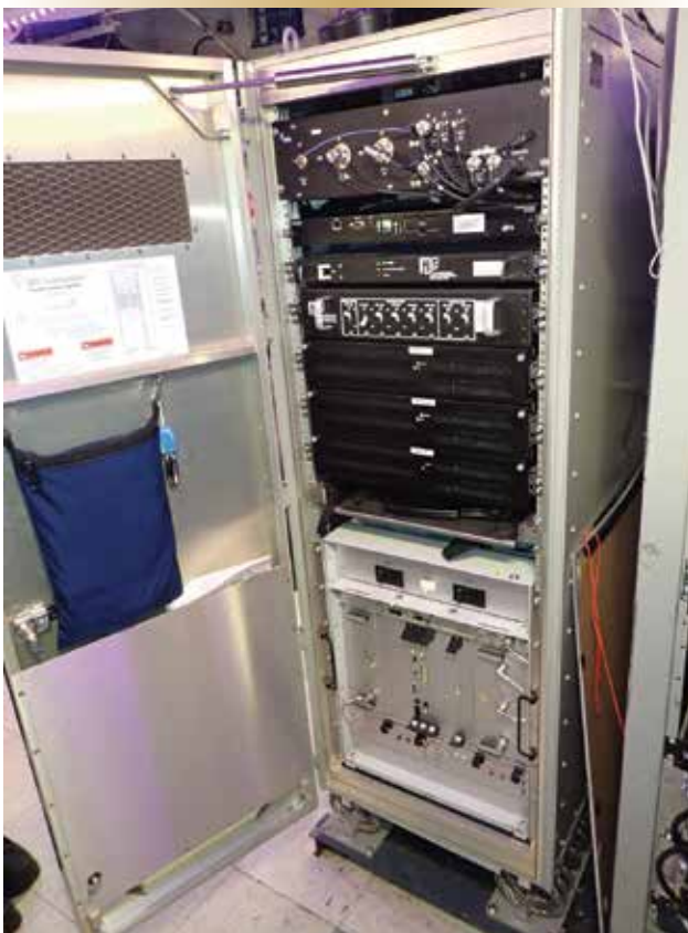
Station de base du SLRCI.
