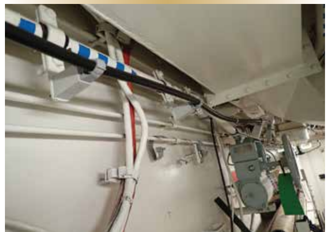
Le chemin de câble (en noir) du système d'antenne distribuée est acheminé dans les coursives du poste du tireur.
