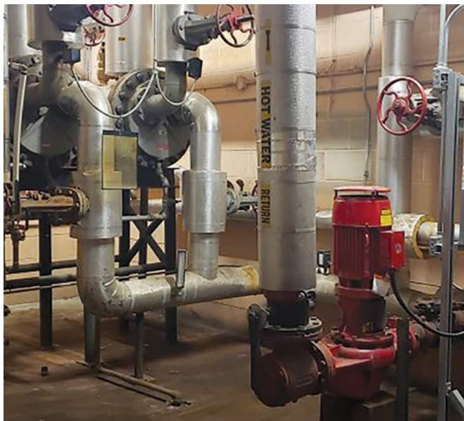
Ce système de distribution du chauffage hydronique a été modernisé à la BFC Kingston pour réduire la consommation d'énergie et la dépendance aux combustibles fossiles, dans le cadre du défi Énergie verte du programme IDEeS.
