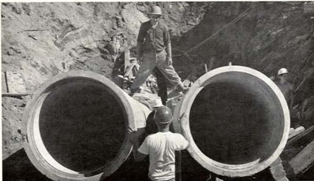
Projet d'épuration des eaux-vannes à Toronto.
