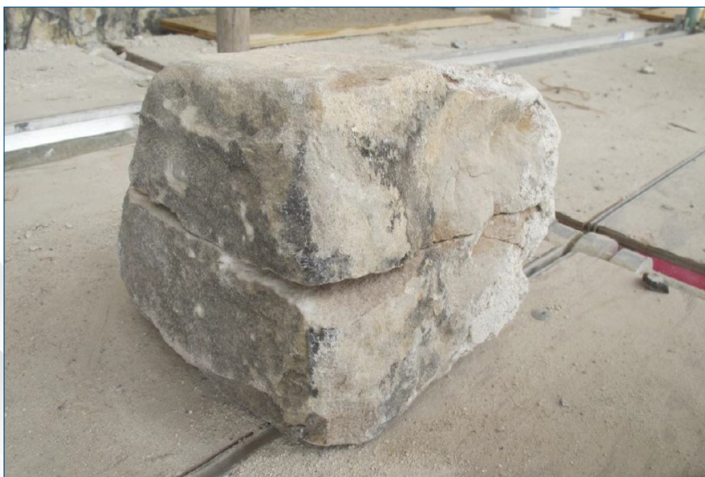
Figure 15 : Unité de maçonnerie fissurée en raison de dommages causés par le gel et le dégel [2]
