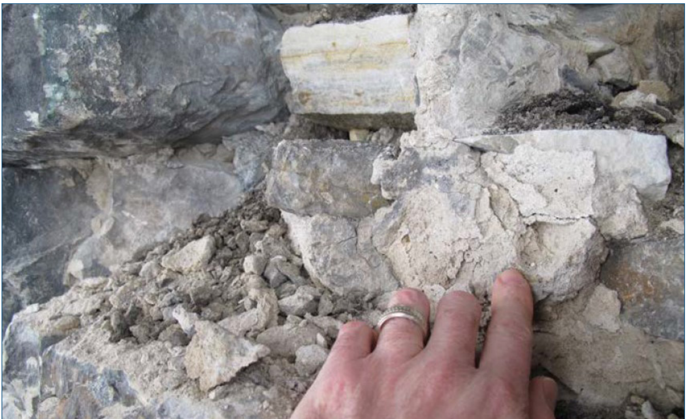
Figure 16 : Noyau de mur détérioré avec des dommages causés par le gel et le dégel [2]
