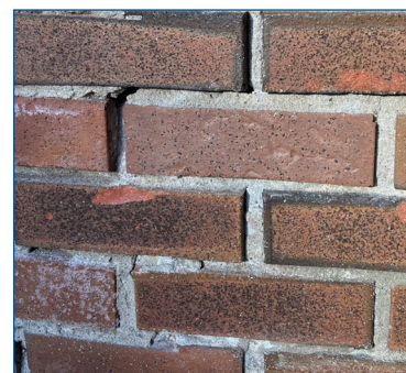
Domages causés par le feu
