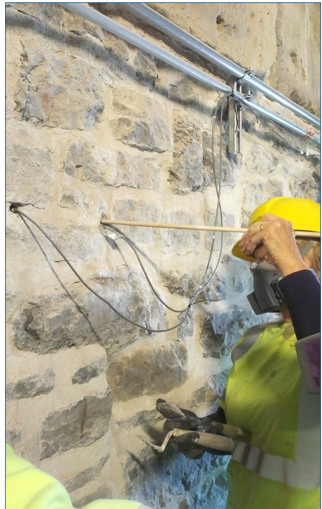
Figure 19 : Installation de capteurs de surveillance dans un mur de maçonnerie [2]
