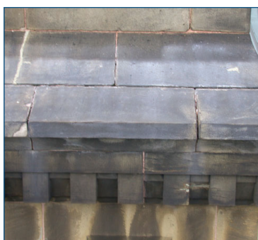
Joint de maçonnerie ouvert [2]
