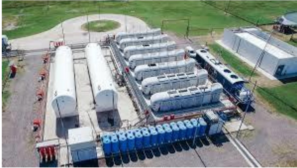
Figure 7: Cyrobox Nano LNG Station
